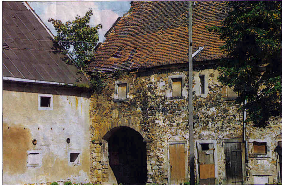
Der Zahn der Zeit hat arg am Limbacher Rittergut genagt. Jetzt will die Stiftung „Leben und Arbeit“ dem Vierseithof wieder zu neuer Blüte verhelfen. In dem rechten Gebäude sollen zum Beispiel Seminarräume und Unterkünfte für Gäste entstehen. Foto: Jana Klameth
