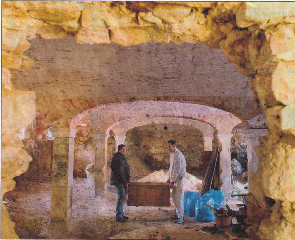
Der zweite Bauabschnitt wird am Rittergut Limbach in Angriff genommen. Maik Schneider (l.) und Bauleiter Robert Göttisch arbeiten hier im zukünftigen Speisesaal. Foto: Holm Helis
